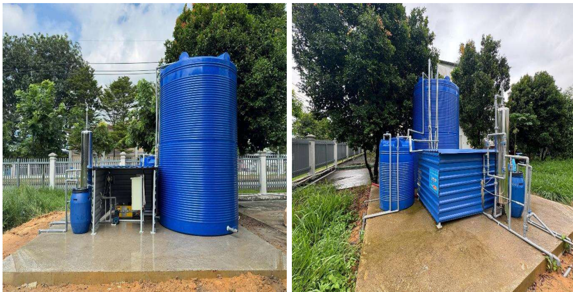
Hình 14: Hình ảnh HTXL nước thải tại cơ sở (hiện hữu)
