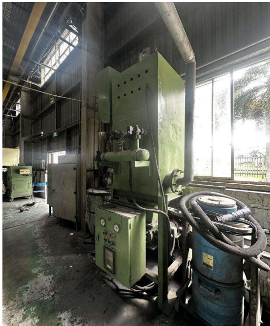
Máy thu bụi khu vực phủ bột xưởng 1
