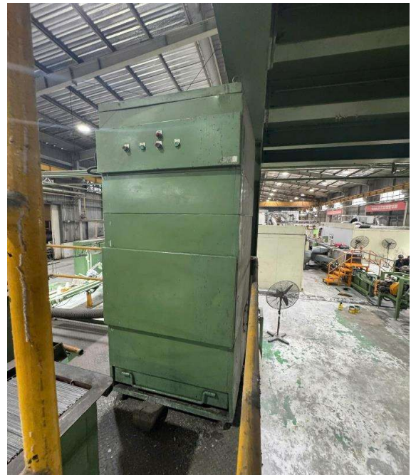
Máy thu bụi khu vực phủ bột xưởng 1
