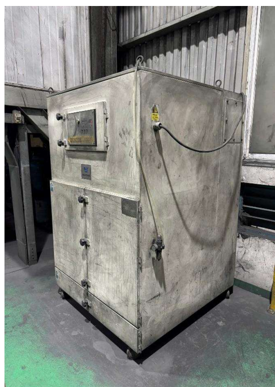
Máy thu bụi khu vực kéo dây xưởng 2
