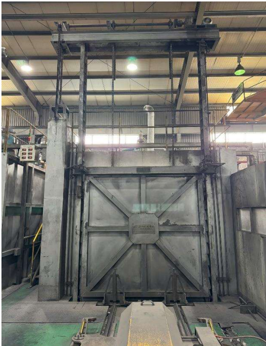
Lò sấy gas số 1 xưởng 2
