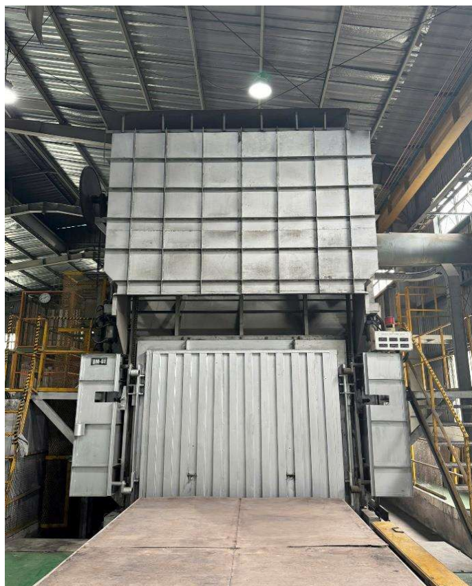
Lò sấy gas xưởng 1
