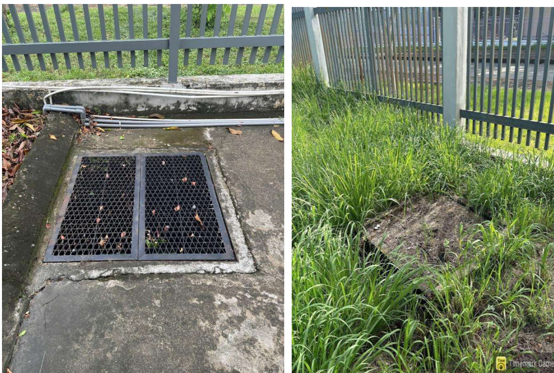
Hình 9: Hình hồ ga đầu nối nước mưa của cơ sở).
